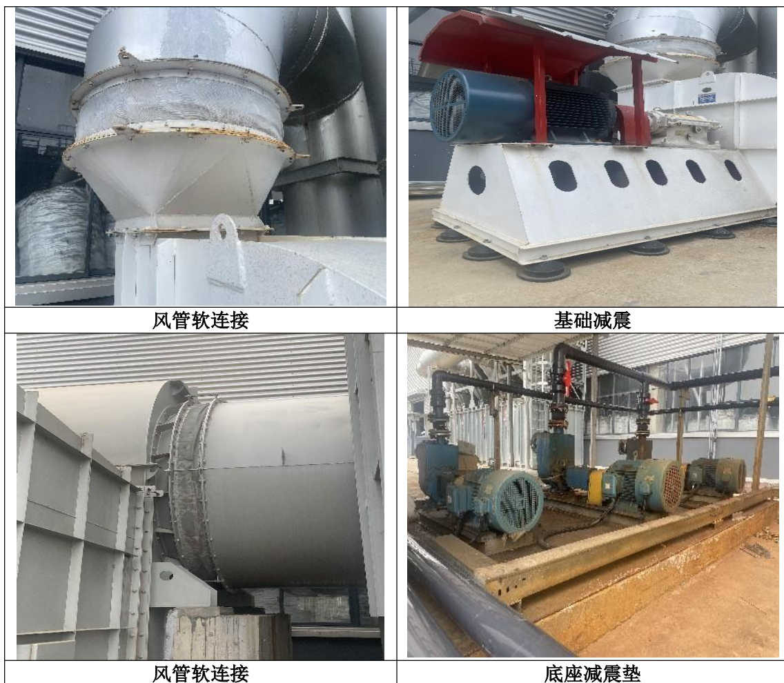
图 4-6 设备降噪措施现场照片
