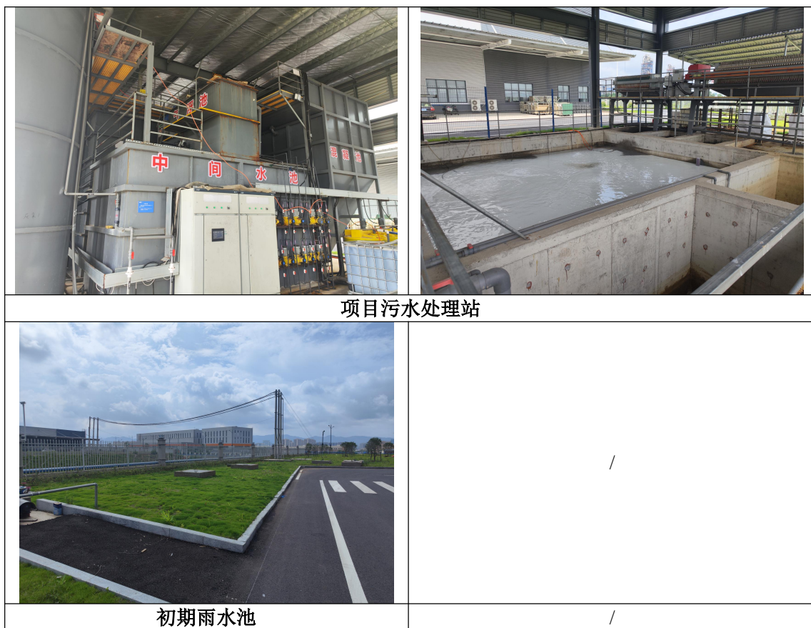
图 4-3 项目污水处理设施
