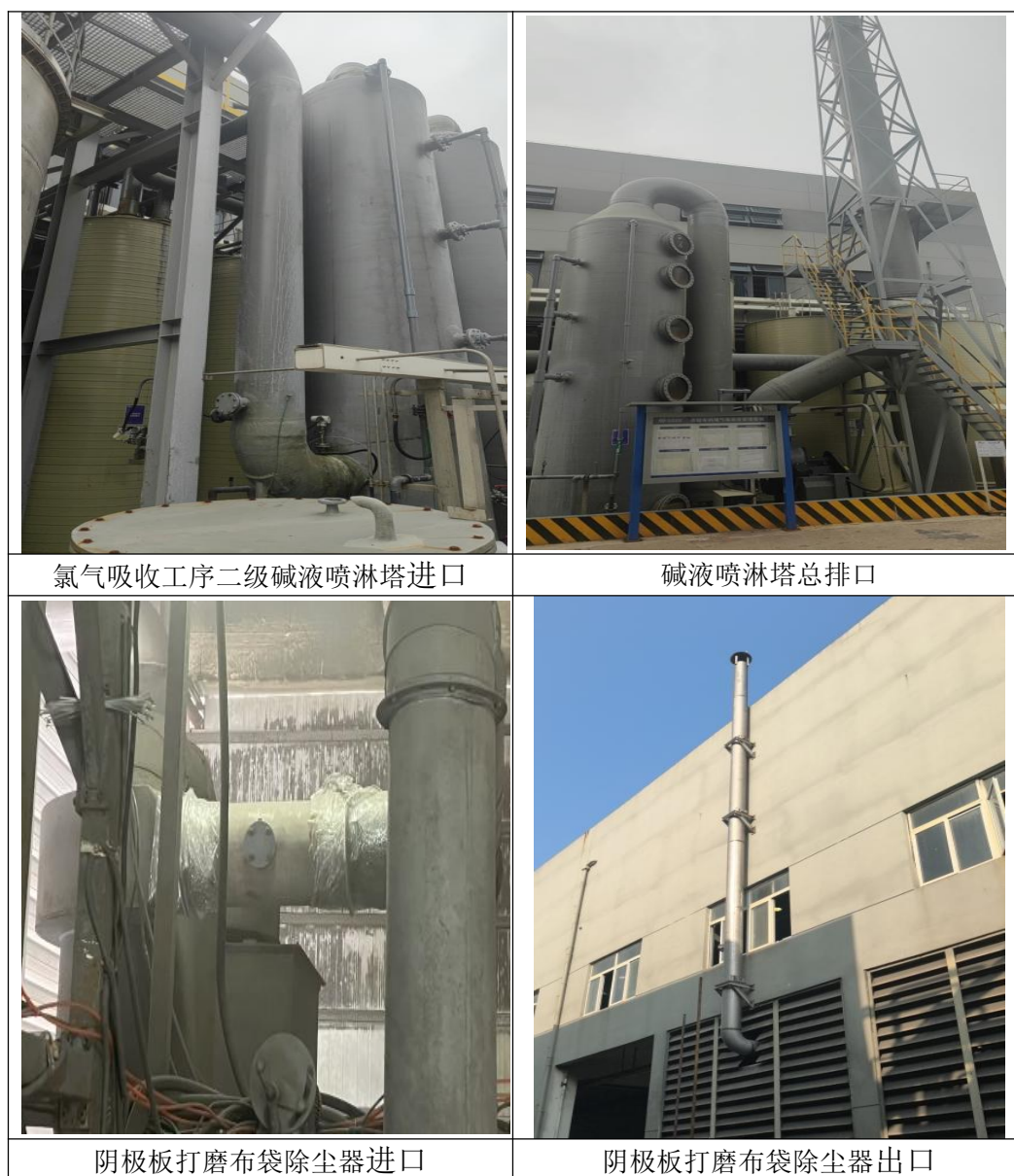
图 4-6 废气处理装置
