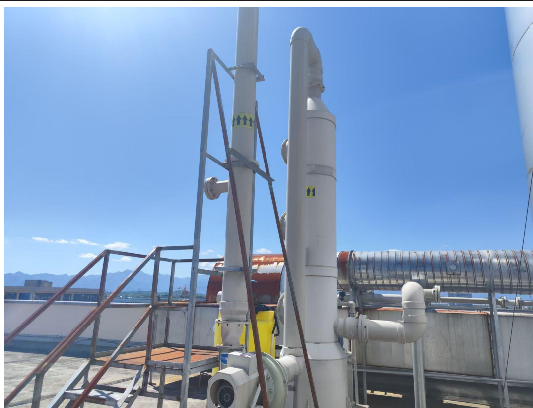
碱液喷淋吸收装置
