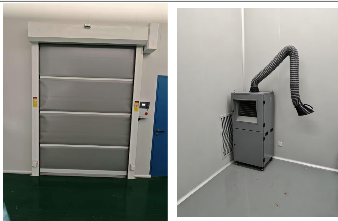
投料间废气处理设施
