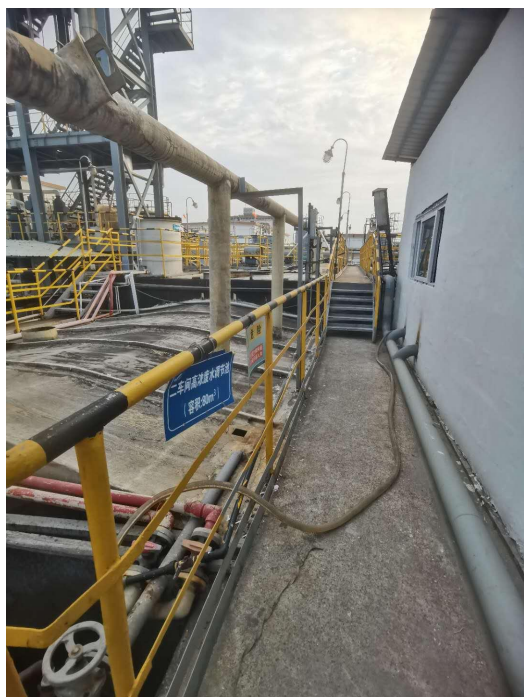
污水站现场照片
