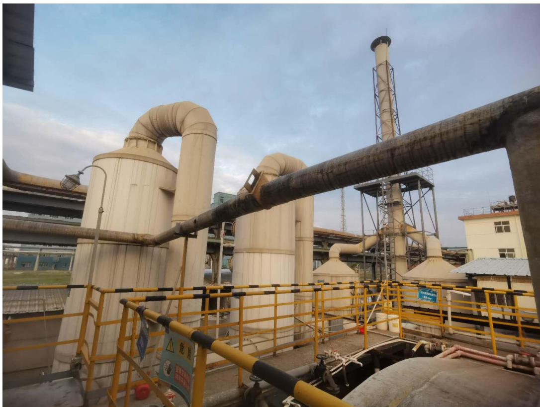
厂区综合尾气处理系统现场照片
