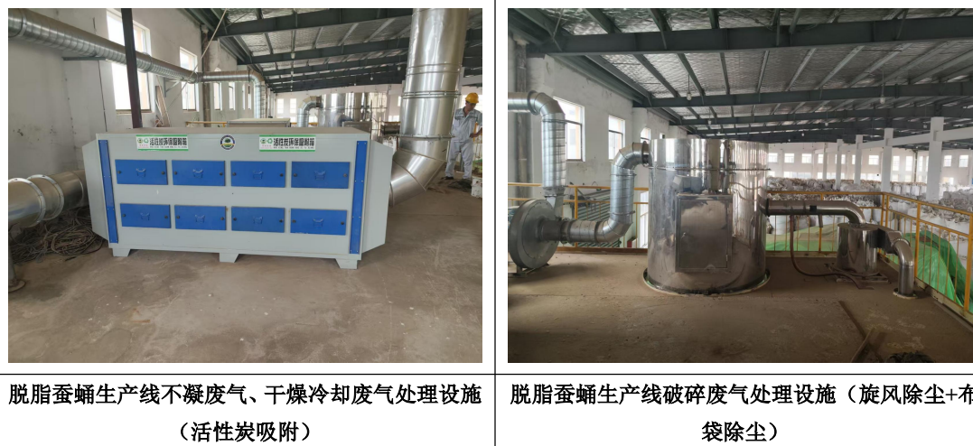
图4-3 项目废气处理设施现场照片
