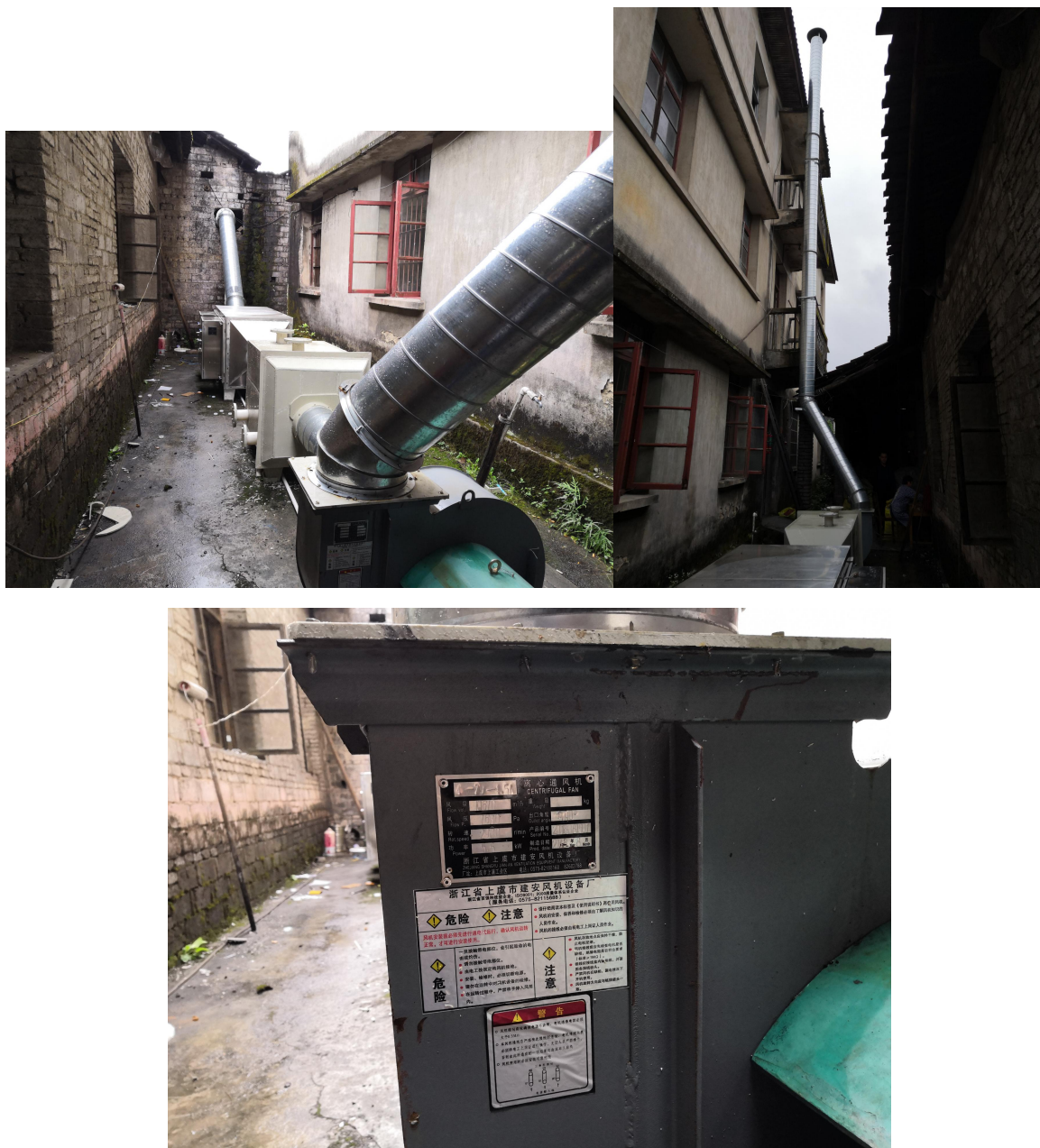
图3-2 油漆废气处理设施
