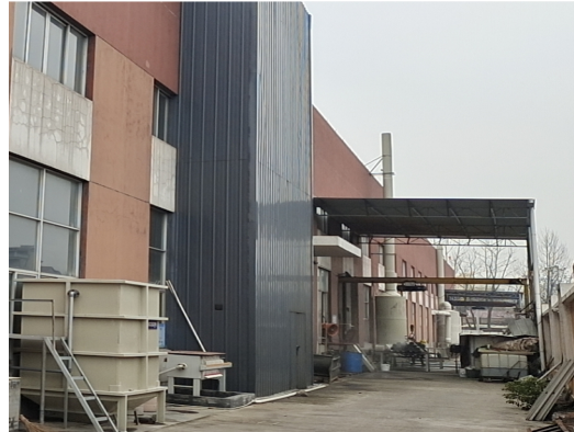
抛光粉尘处理设施
