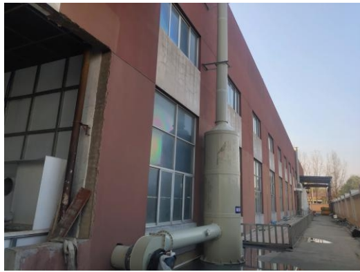
酸雾废气处理设施
