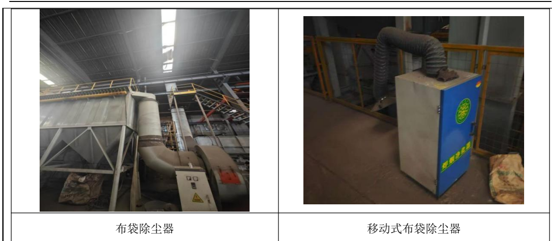
图 4-3 项目废气处理设施及排放口
