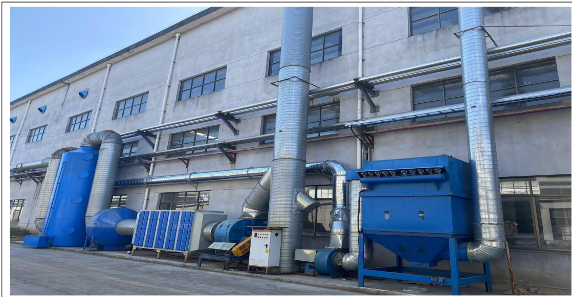
图 3.2-2 废气处理设施
