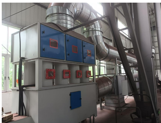
有机废气处理设施（水喷淋）
