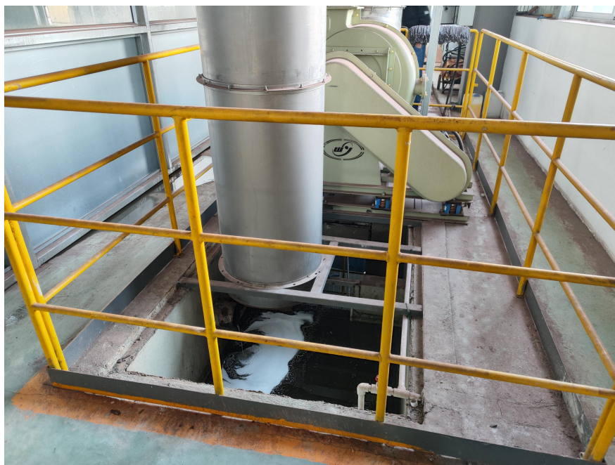
图4-2 清洗废水沉淀池
