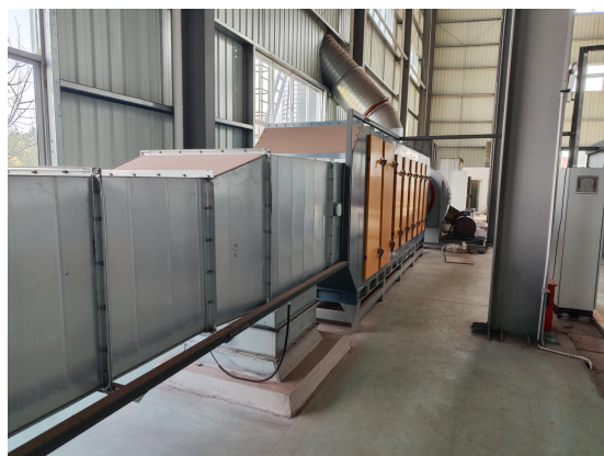
有机废气处理设施
