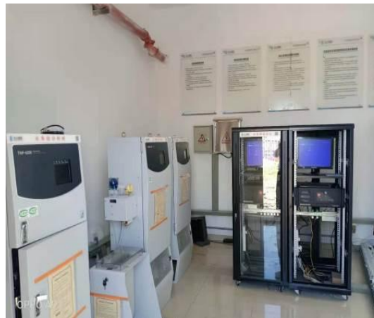
废水在线监测系统
