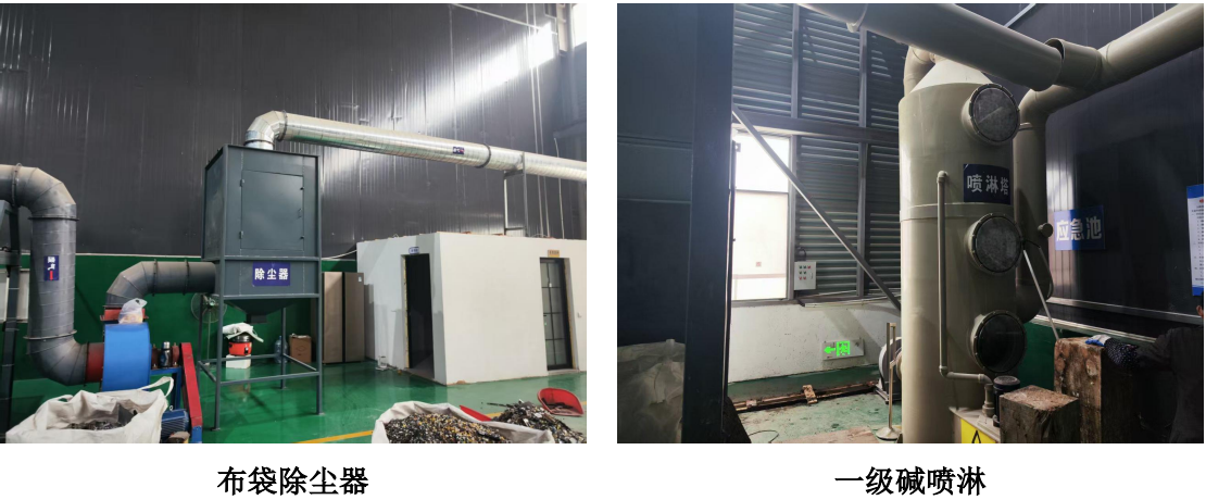
图 4-4 项目废气处理设施
