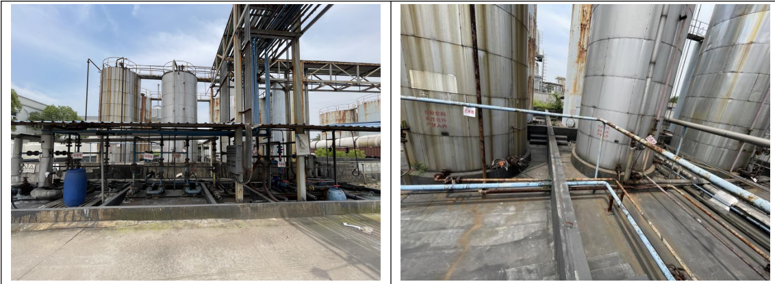
原料罐泵区，离地管道和泵
